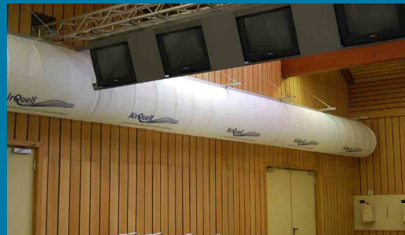
Въздухоразпределител с обръчи в неработно състояние
